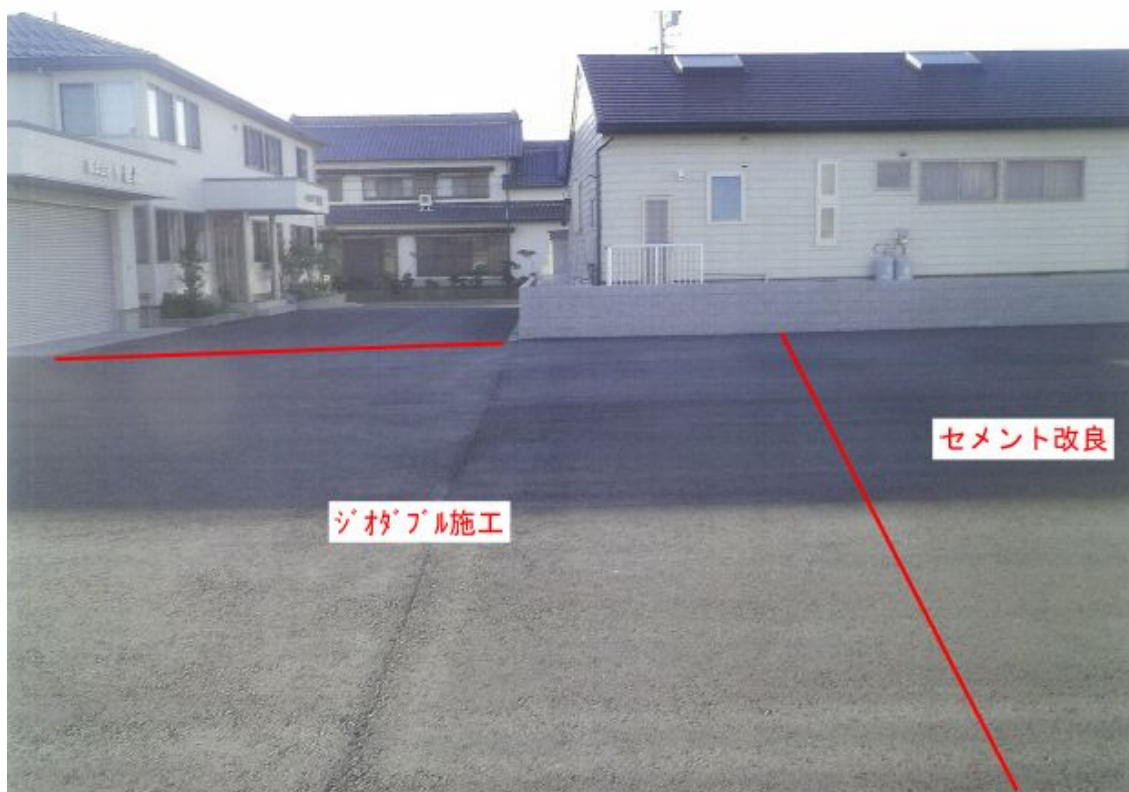
2年経過後の駐車場写真
